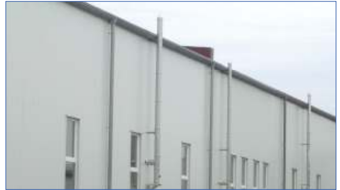
Abgasführung über Außenwand bis über Dach mittels doppelwandigem Edelstahl-Fertigschornstein DW Multi-Line.
