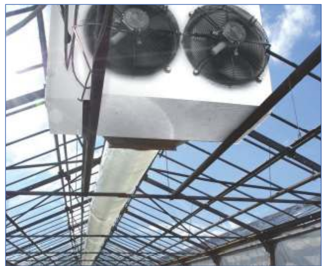
Beheizung eines Gewächshauses mit einem Gasatherm F-100 und Luftverteilung über Folienschlauch (Sonderzubehör).
